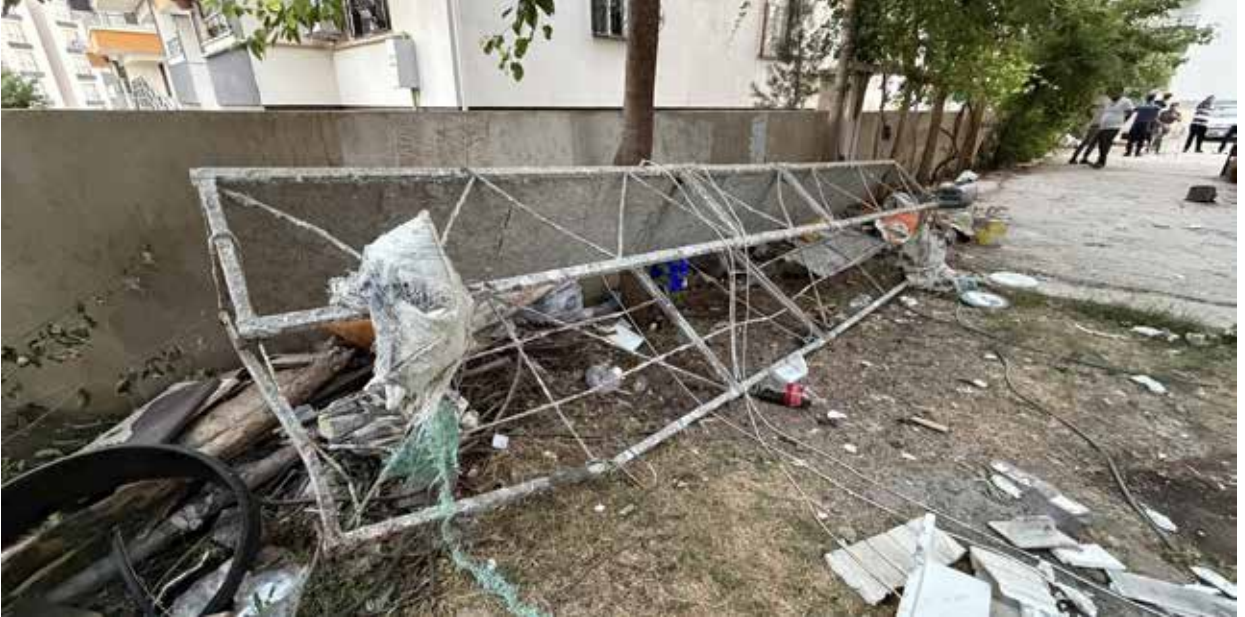
Resim 1 - İki bağlantı halatının kopması sonucu, M.M.Toruntay ve M.Kızılkıran'la birlikte düşen iskele platformu (5,8)
