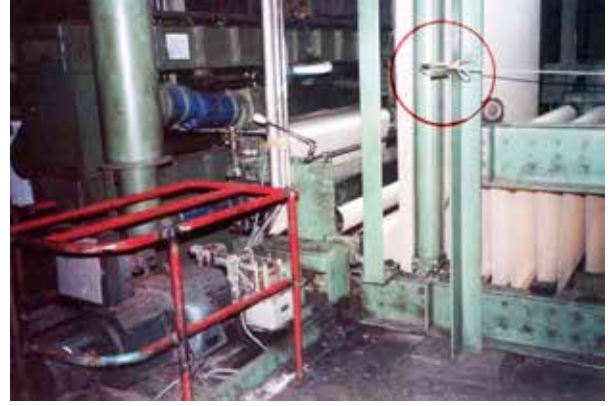
Resim 16– S.K.'nın iş kazası geçirdiği yerdeki acil durdurma teli, kazanın oluştuğu yerde iptal edilmiş
