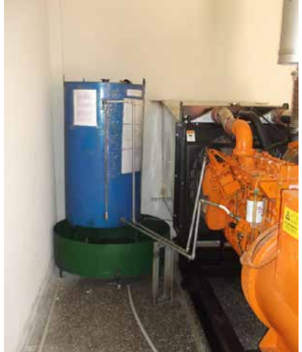
Resim 6- Yedek yakıt deposundan olası sızıntılara karşı yapılan ve deponun altına konulan güvenlik kabı (havuzu).
