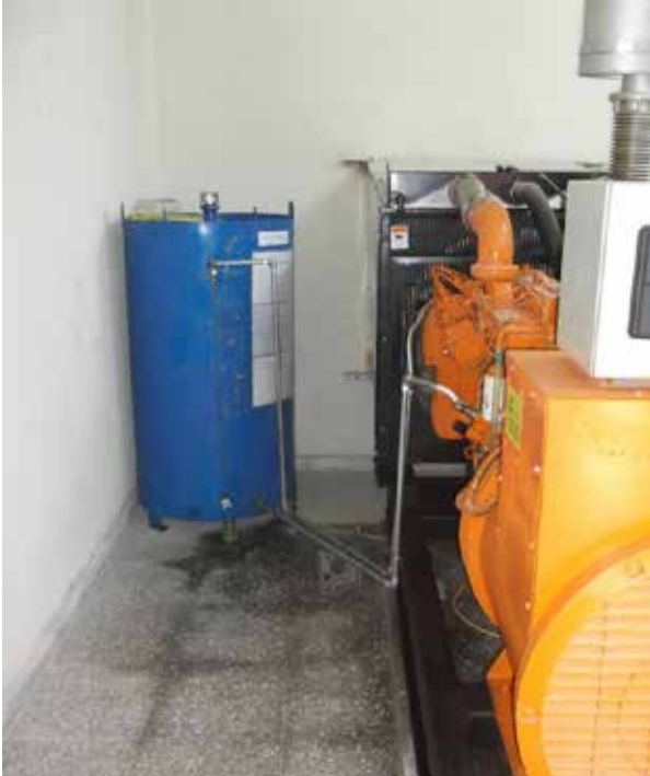
Resim 5- Bir işyerinde kullanılan jeneratörün yedek yakıt (motorin) deposu. Dolum esnasında ya da seviye göstergesi gibi bölümlerden sızarak zemine dökülen yakıt.
