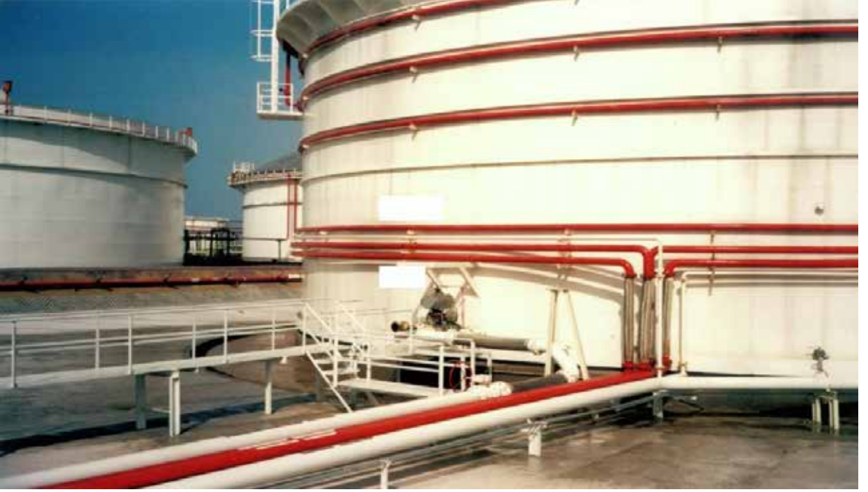
Resim 18- Boru donanımının bağlantıları, taşınan kimyasal ve basınca uygun esnek çelik örgülü bağlantı borularıyla yapılmış (17/08/1999 depreminde hasar gören tank çiftliği).
