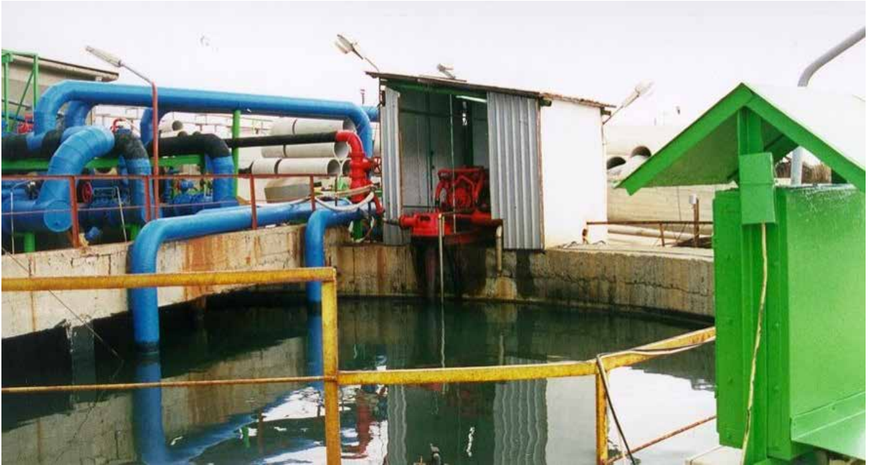
Resim 13- 17/08/1999 günün güvenlik havuzuna kazara dolan zararlı ve tehlikeli kimyasal (gerektiğinde tahliye işlemi yapabilmek için pompa ve kontroller güvenlik setinin dışına (28) yerleştirilmiş).
