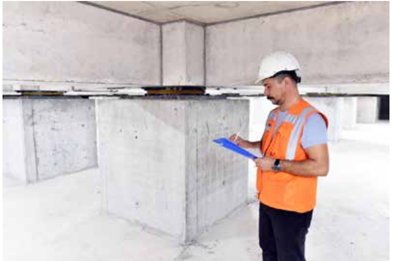
Resim 6 - Dörtyol Devlet Hastanesi'nin deprem izolatörleri (11)
