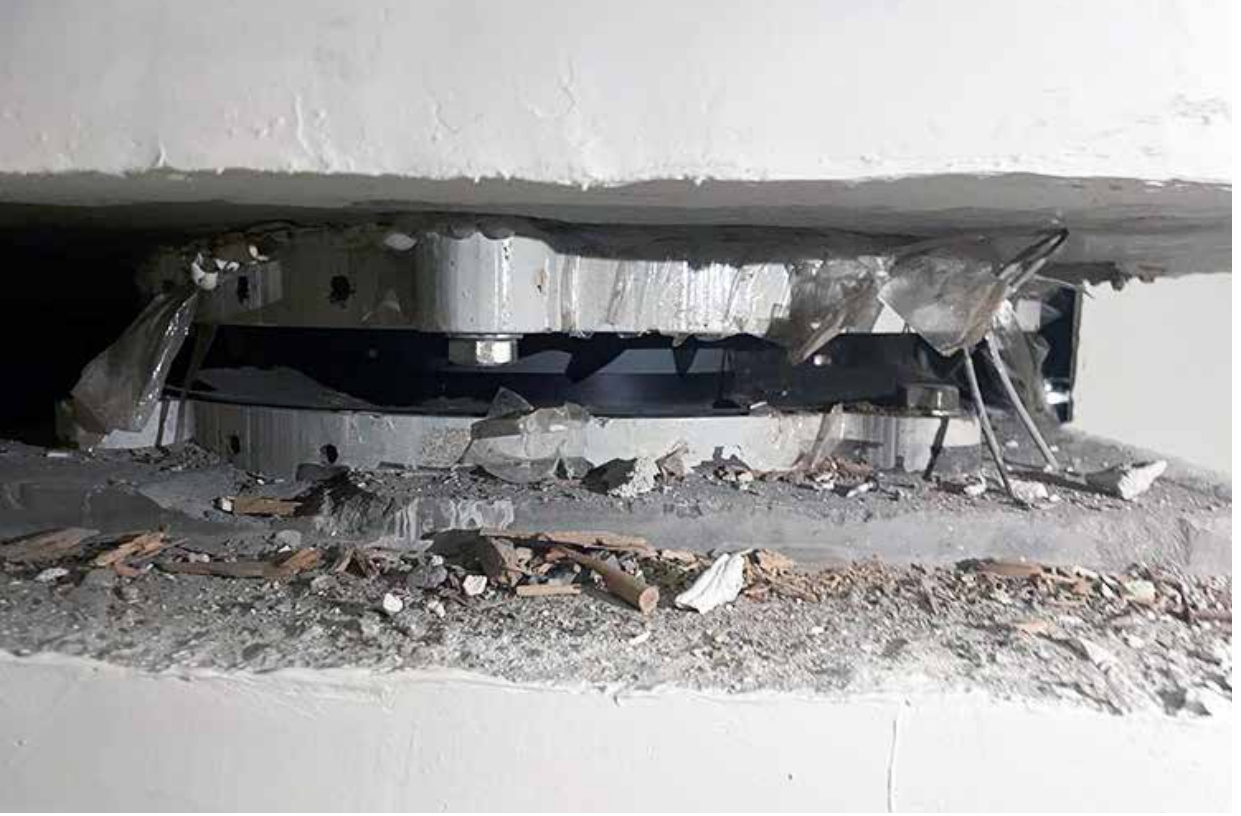
Resim 5- Elbistan Devlet Hastanesindeki sismik izolatörlerden biri (10)
