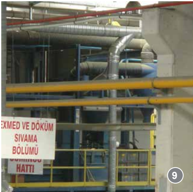
Resim 9- Doğal gaz, basınçlı hava boruları, korkuluklar ve aspirasyon kanallarının üzerine biriken tozlar
