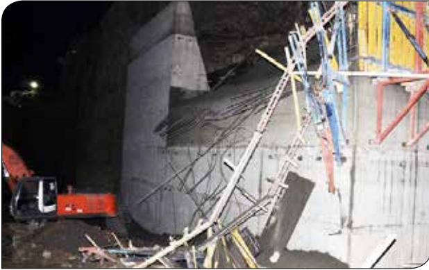
Resim 1: 11.01.2014 günü, baraj inşaatında iş kazasında 3 işçi beton blok, harç ve kalıplarının altında kaldığı yer.
