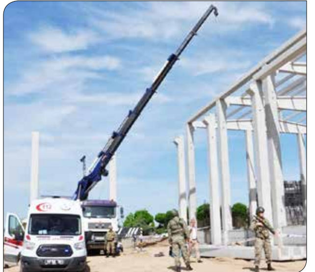
Resim 1 – Beton kirişi kaldırırken kopan halat
