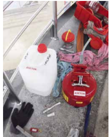
Bir sistem (örneğin; HES'de stator ve rotor) temizliğinde aseton gibi -çok kolay yanıcı - maddeler – çalışma sahasında- güvenlik kablolarında (safety cans) bulundurulmalı ve kullanılmalıdır.
