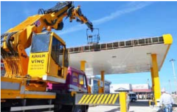
Resim 2- Çalışanın düştüğü vincin sepetinin durumu (10,11,12)
