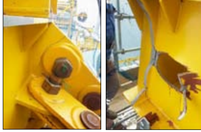
Resim 2(a,b): Japon Mühendisi İntihara Götüren Çatlak (Kaza Öncesi ve sonrası) (6,7,8,9,10)
