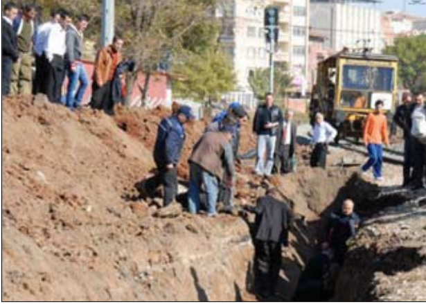
Resim 3 – Kanalizasyon çalışmasında göçük (6)
