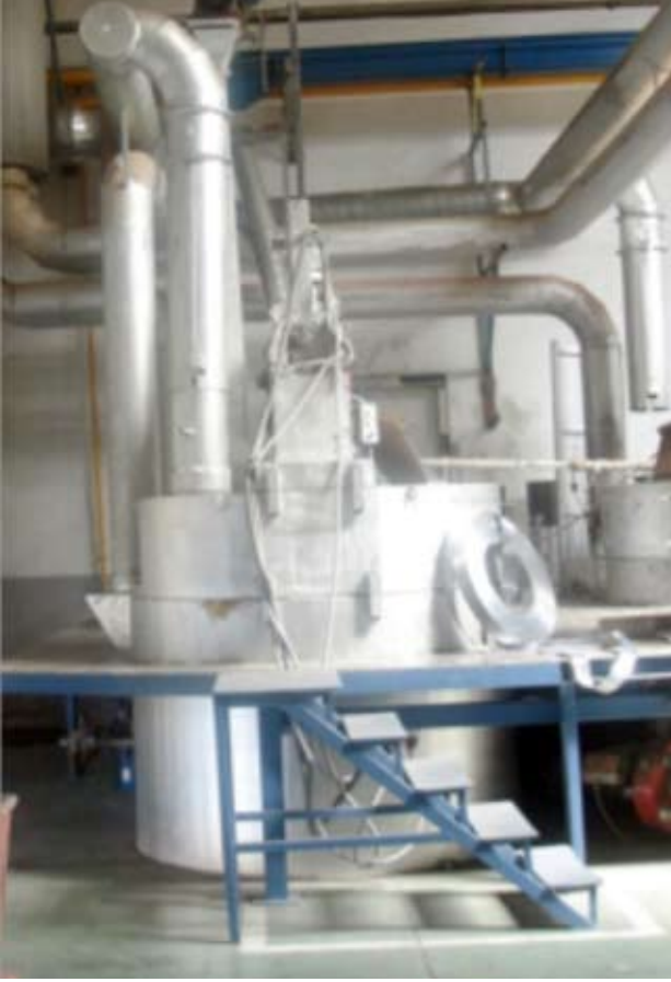
Resim 3 – Beş basamakla çalışma platformuna çıkılan, korkuluğu ve trabzanı olmayan merdiven.
