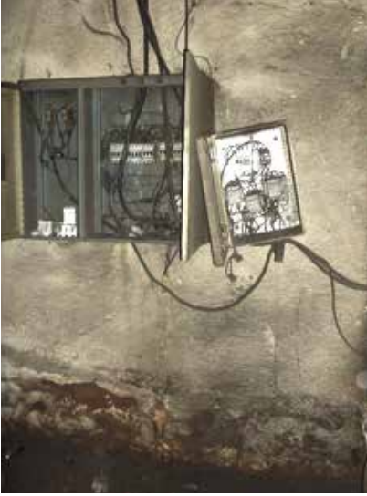
Resim 6- Ankara'da işyerinin elektrik donanımı.
