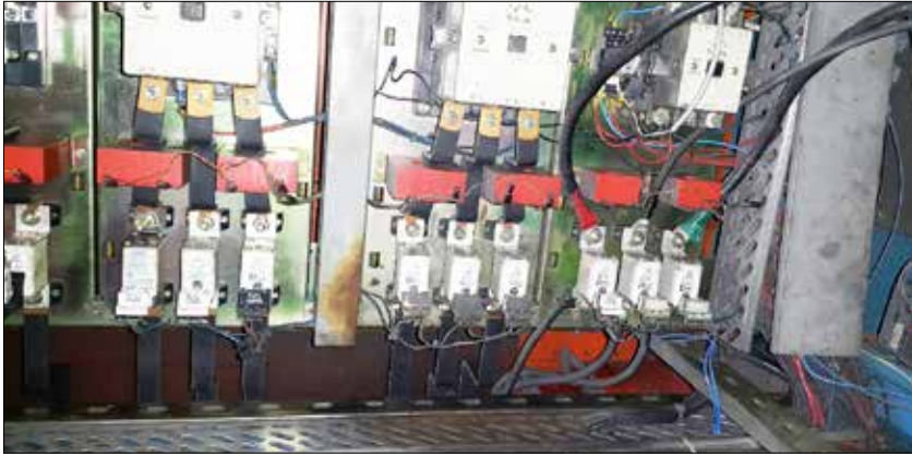
Resim 3: Patlama oluşan panel (onarım sonrası)
