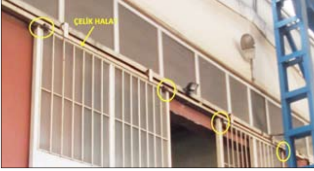
Resim 11- Raydan çıkmayı ve devrilmeyi önleyici güvenlik sistemi uygulaması.
