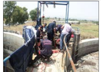
Resim 10 : Bir Mühendis ve iki işçinin öldüğü Manisa Dericiler Sitesi Arıtma Tesis (30) .
