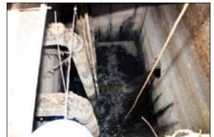
Resim 2 : Yalıkavak Beldesi Atıksu Terfi İstasyonu.
