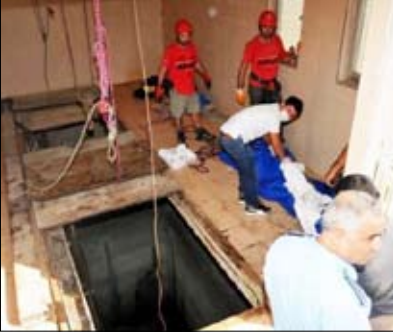
Resim 3: Yalıkavak Beldesi Atıksu Terfi İstasyonunda ölen işçiler (13,14) .
