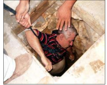
Resim 1 : Adana'da atıksu kanalında ölen işçi (9)
