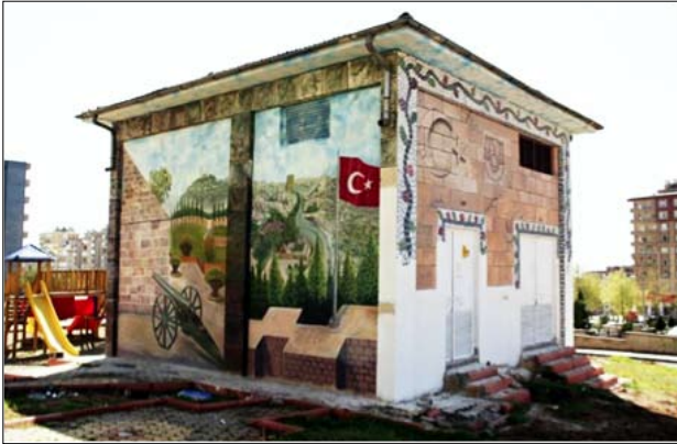
Resim 1; Dış duvarlarına resim yapılan park içindeki bir trafo.
