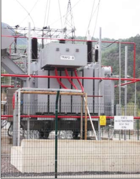
Resim 13: Yangın algılama ve söndürme sistemleri ile donatılmış 154kV'luk trafo.
