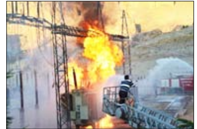
Resim 12: Kısa kollu T-shirt ile trafo yangınına müdahale eden itfaiyeci
