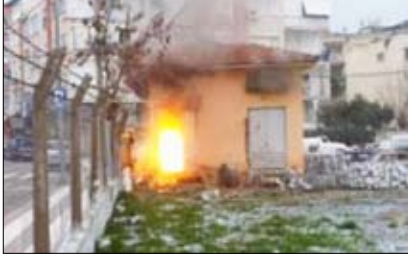
Resim 5: Park içinde (üzerine henüz resim yapılmamış) trafo'nun patlama anı.
