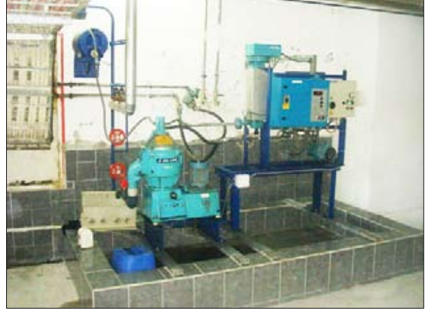
Resim 2 b- Yapılan iyileştirme: Yağ pompası bir güvenlik havuzunun üzerine alınarak olası kaçakların çevre kirliliği ve kayarak düşmeyi önleyecek duruma getirilmesi.
