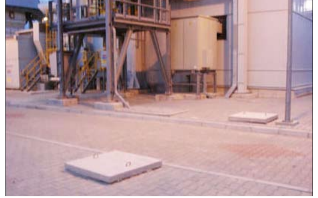
Resim 1 a- Çalışma sahasında özellikle acil durumlarda, gece vardiyalarında takılarak düşmeye neden olabilecek beton rögar kapakları.
